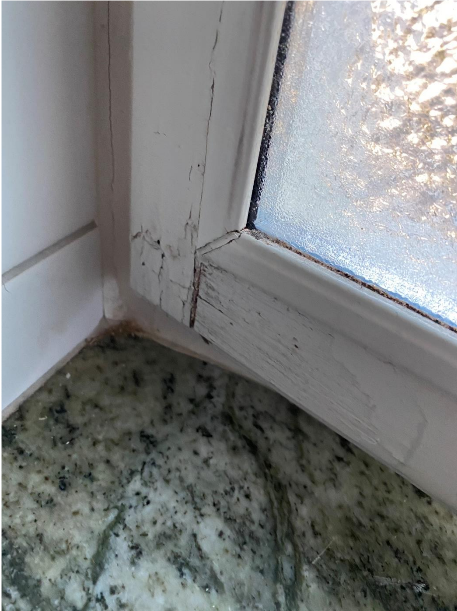
LGH 31, Röta i fönsterbåge (insidan)
