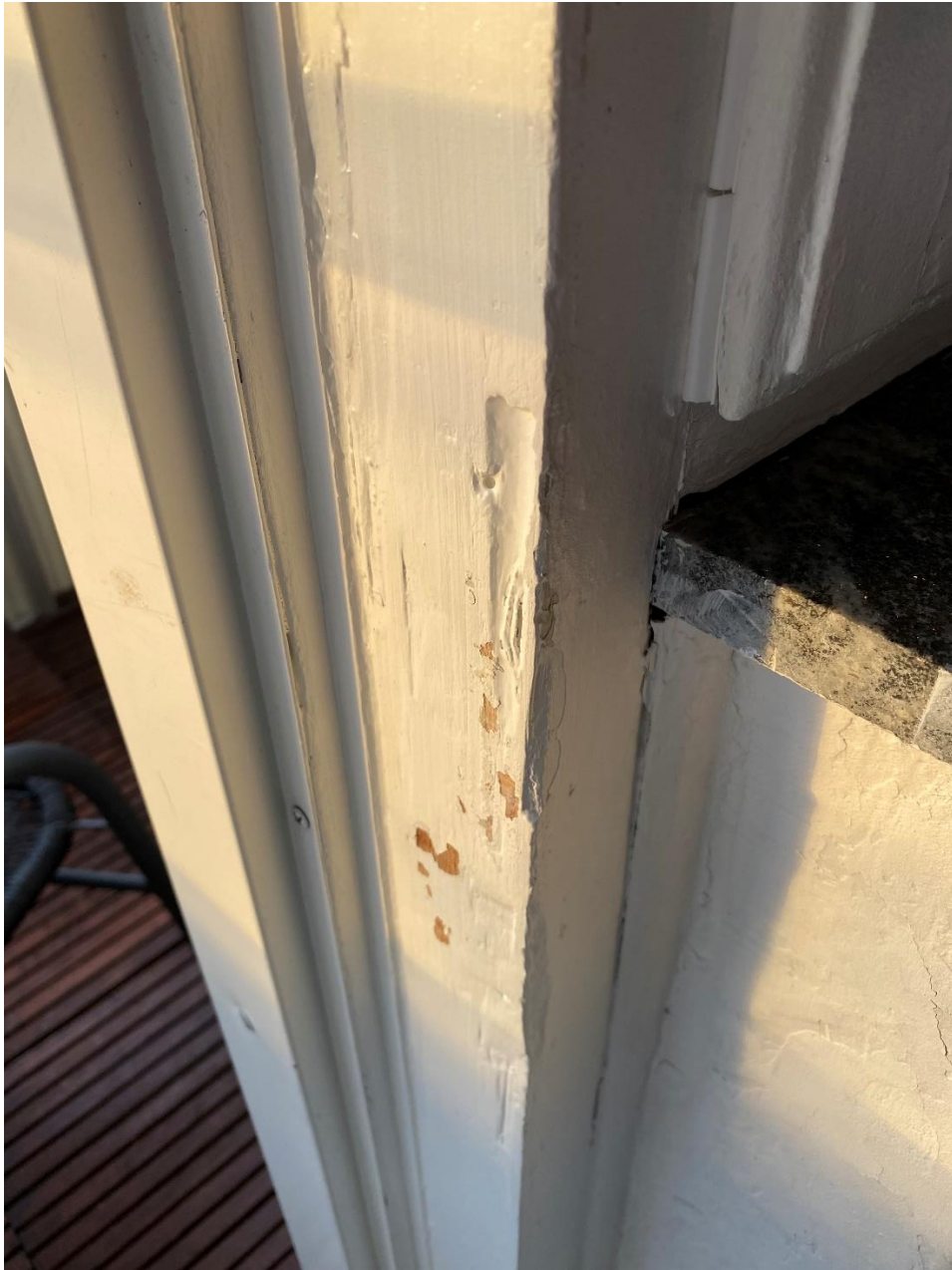
Klämskada, Balkongdörr tar i karmsidan
