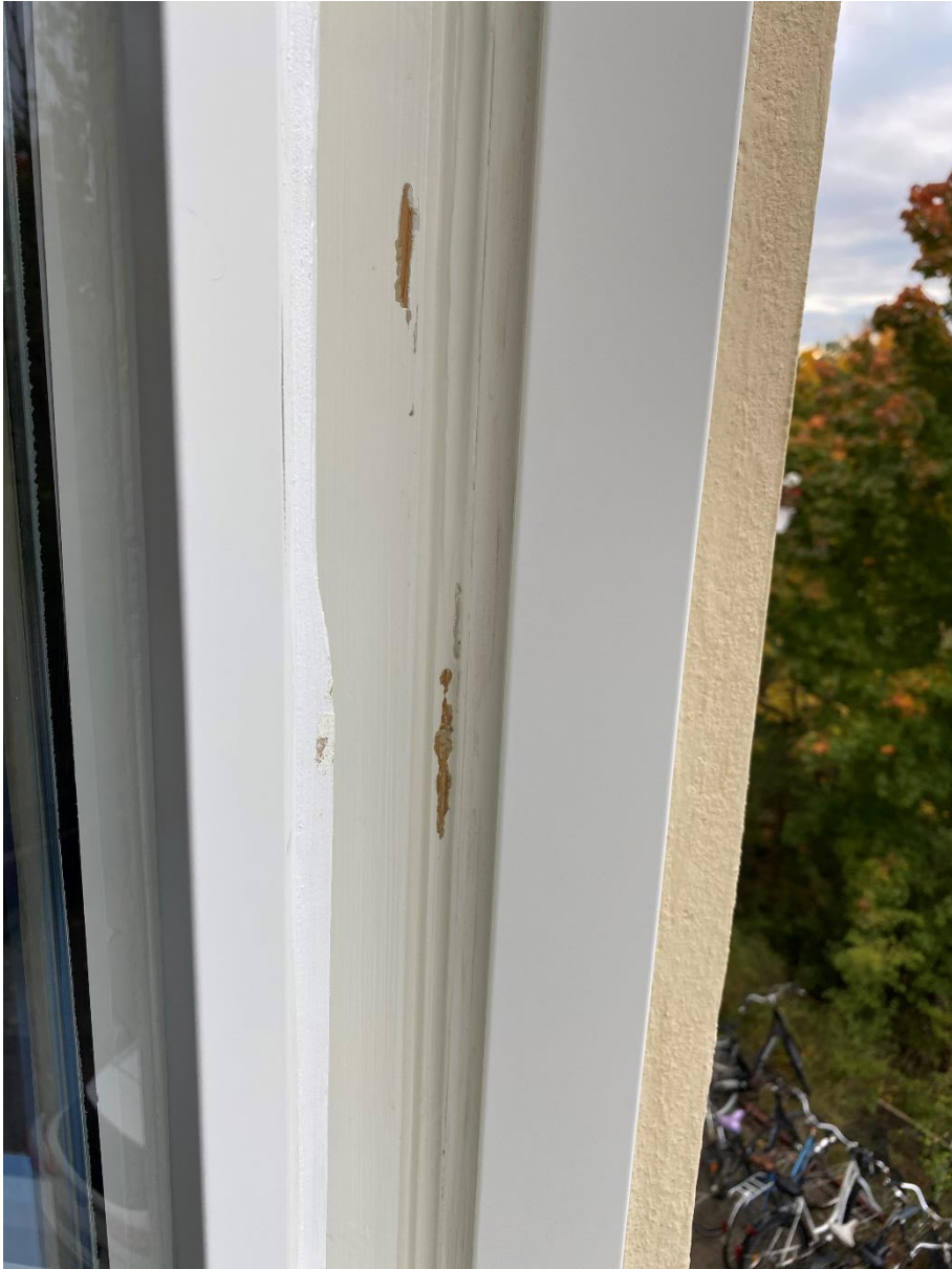
Klämskada bakkant fönster samt karmfals
