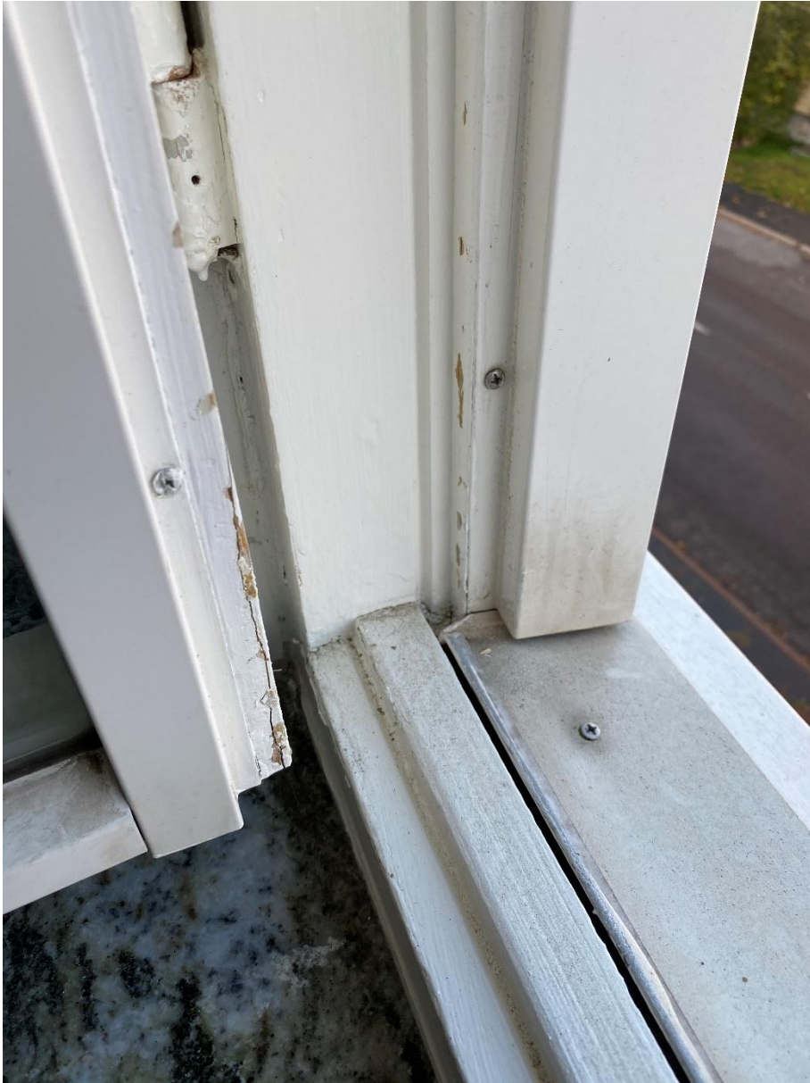
Klämskada samt spricka i bågsidan.
